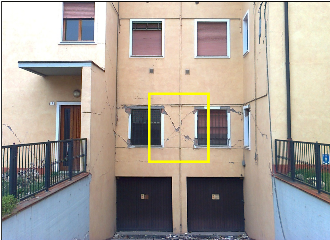
Maschi murari deboli (lesioni al piano terra)
