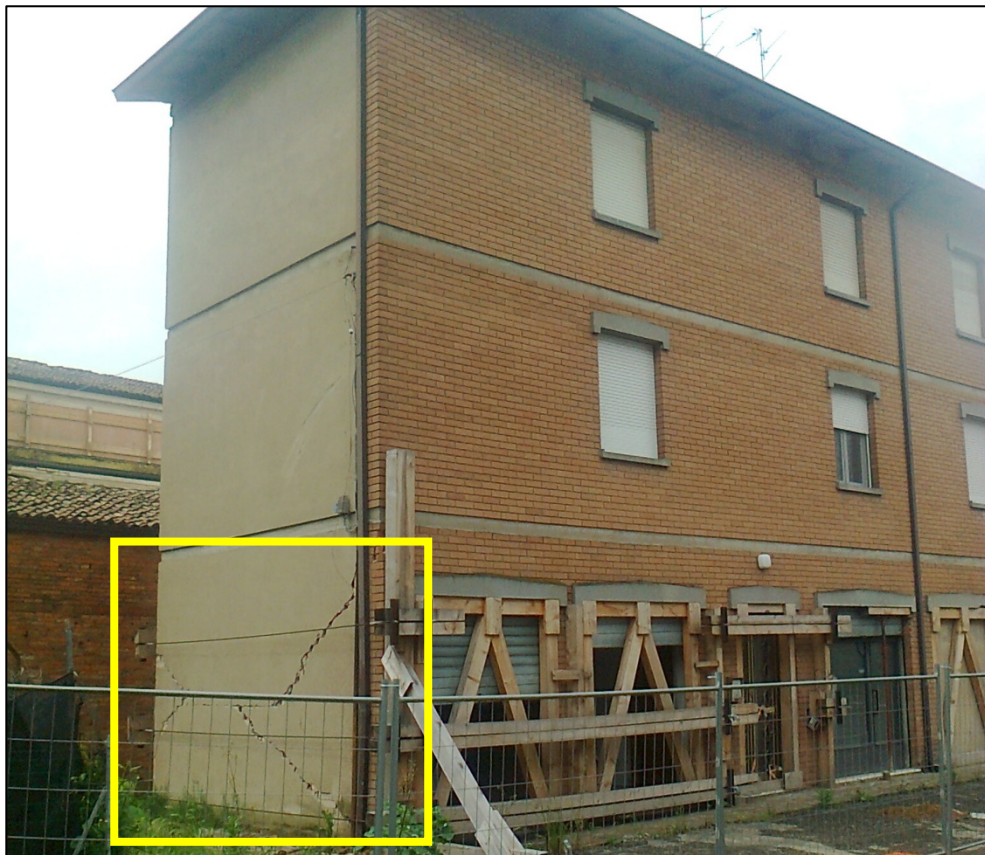
Maschi murari deboli (lesioni al piano terra)
