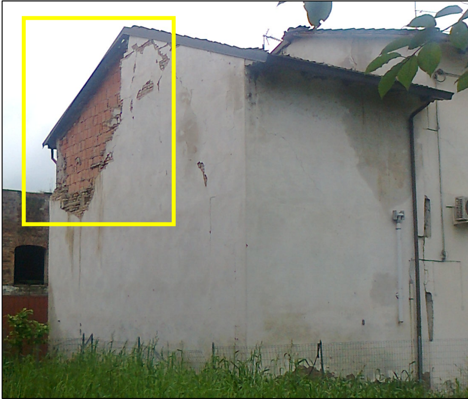
Paramenti di muratura in laterizio non collegati
