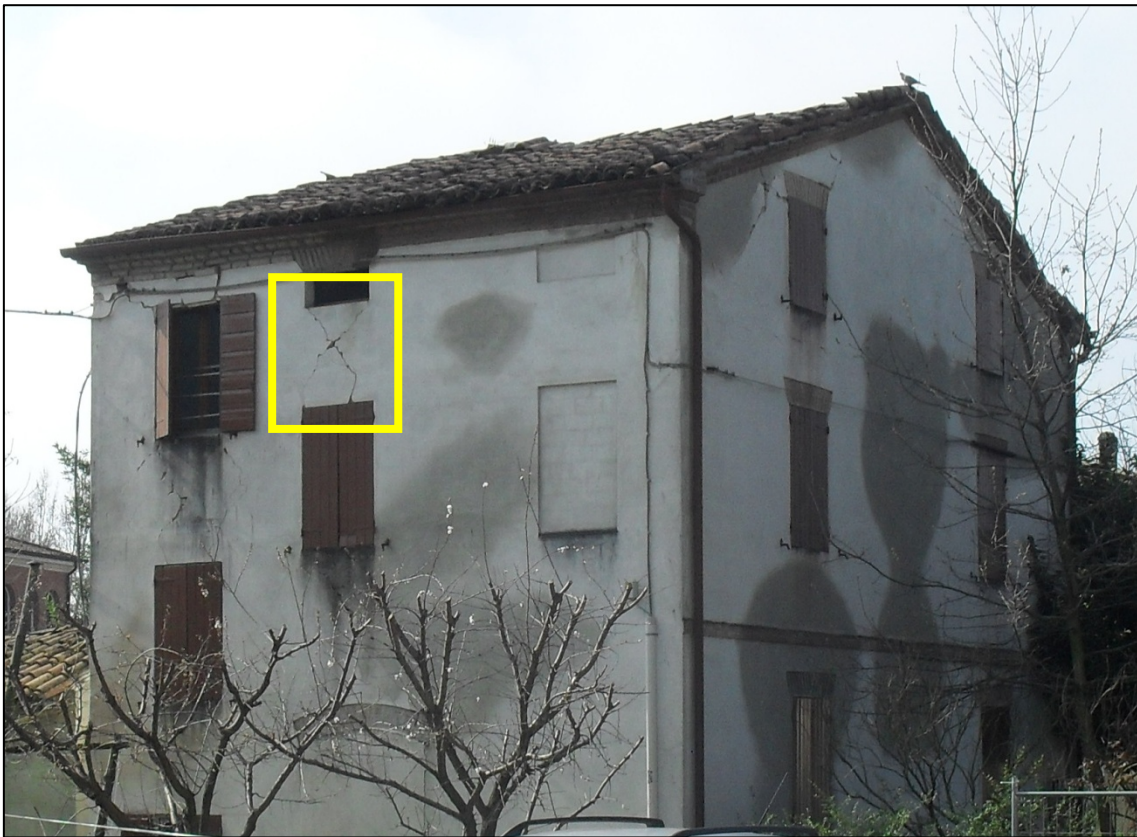
Fasce murarie deboli (lesioni più accentuate negli ultimi piani)
