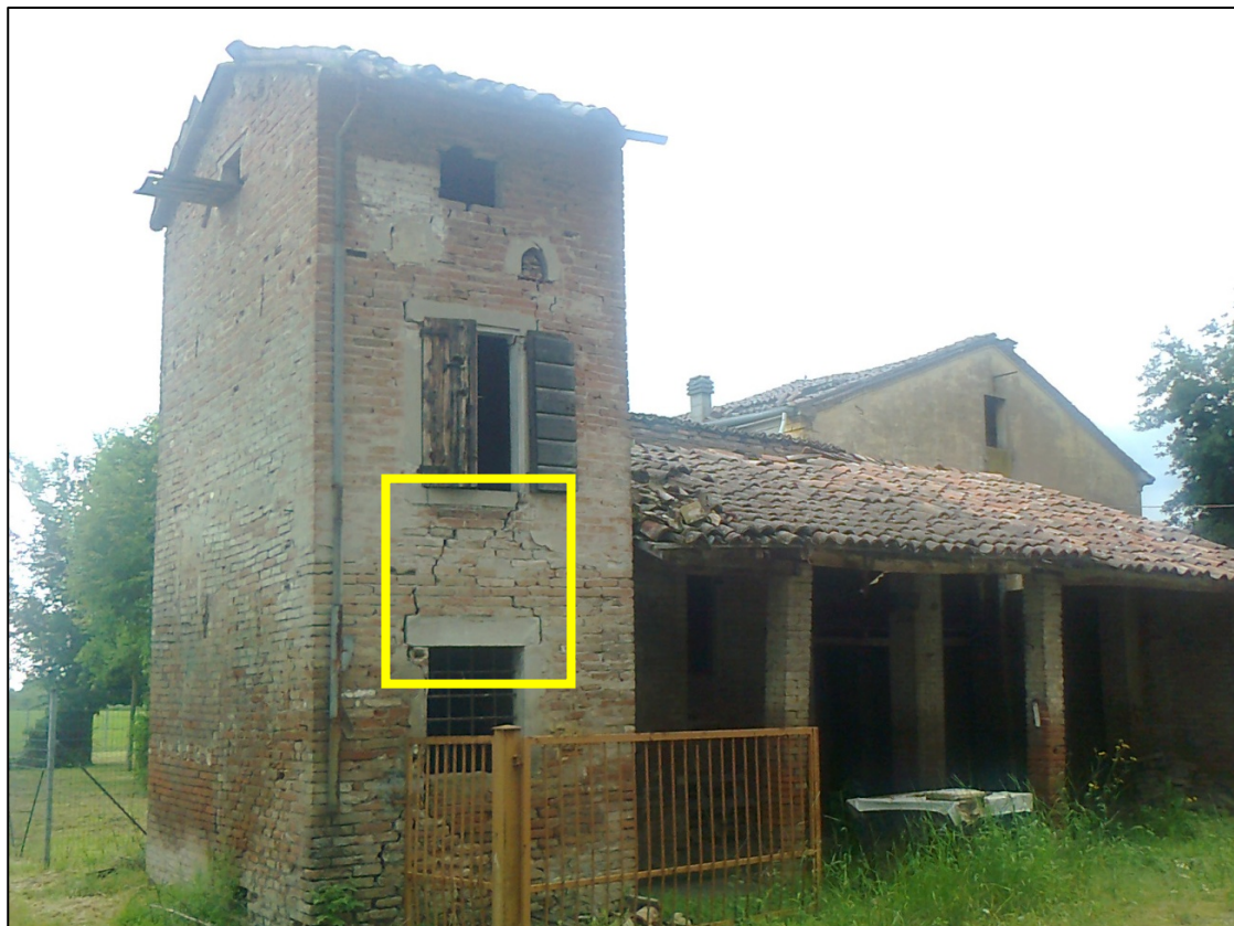
Fasce murarie deboli (ancoraggio dell'architrave insufficiente)
